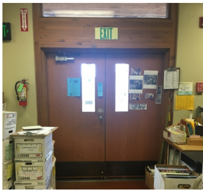
(Photo 46) Non-compliant egress door
